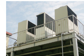
京都・電装工場(写真中央1台)
