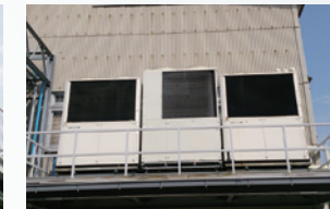
京都・工場事務所(写真中央1台)
