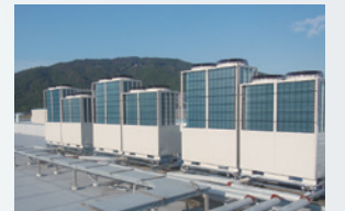
安土・事務棟(6台)
