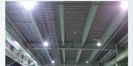
京都・出荷センター(14灯)
